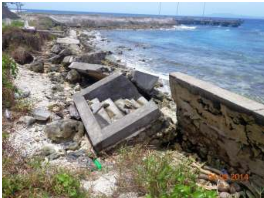
Foto talud penahan gelombang air laut yang jebol
